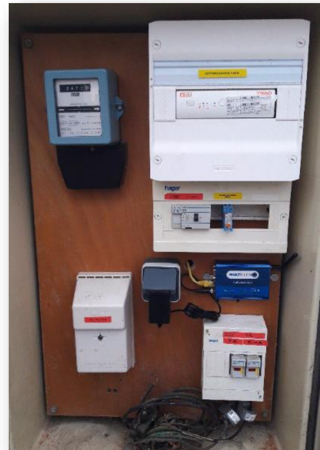
Après mise en place de la télégestion
